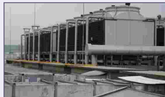
Системы вентиляции/кондиционирования и водоснабжения
